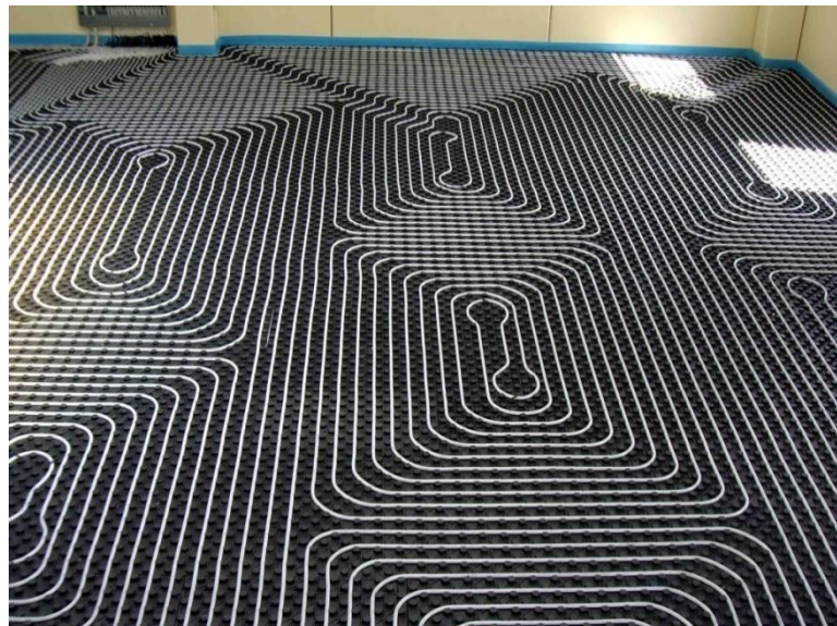
impianto riscaldamento a pavimento
