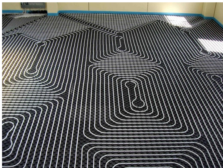
impianto riscaldamento a pavimento
